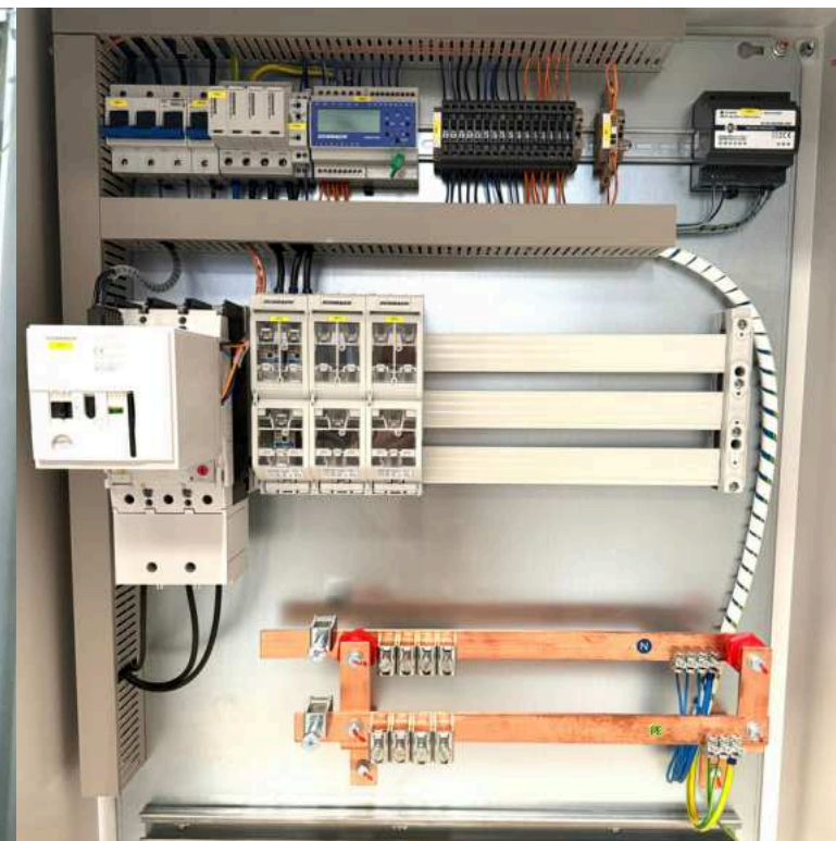
PV - ABSCHALTSCHRÄNKE / PV - VERTEILER
